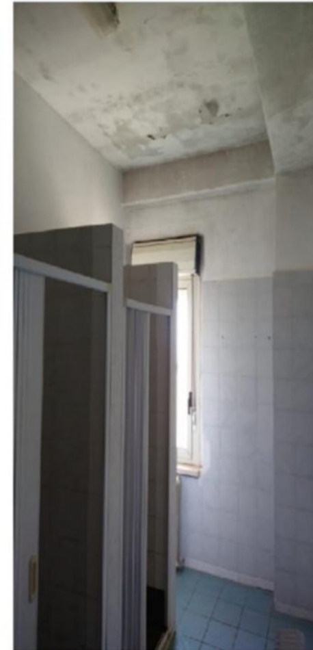
46 – bagno grande 1° piano, grande presenza di muffe su parete perimetrale e soffitto
