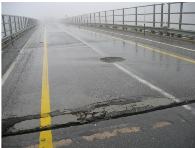
Cedimento giunto in direzione trasversale
